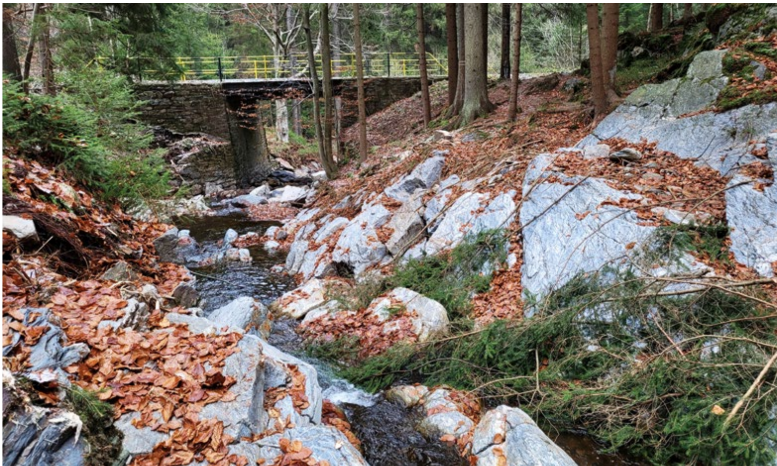
Obr. 8. Eroze akcelerovaná povodní v září 2024 vedoucí až k destrukci stupňů v korytě Slučího potoka a obnažení skalního podloží (foto: J. Unucka)
