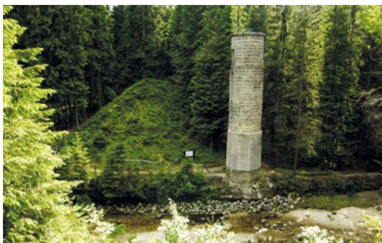
Obr. 7. Protržená přehrada na Bílé Desné – torzo hráze protržené v roce 1916, rok po dokončení stavby; červen 2012 (Foto: D. Vondrák)
