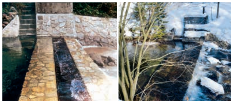
Obr. 10. Jímací objekt na Hučivé Desné, stav po výstavbě v roce 1997 (Archiv ŠPVS), současný stav vpravo (březen 2022, A. Létal)
