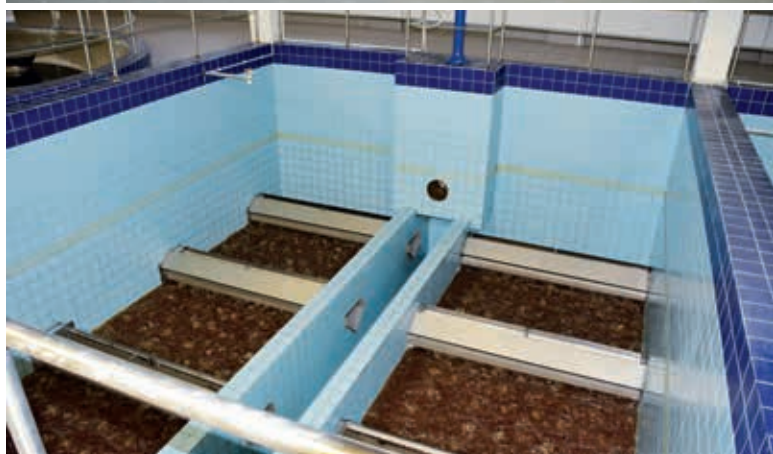
Obr. 5. Úpravna vody v době výstavby (Archiv ŠPVS), po rekonstrukci v roce 2008, pohled do haly s reakční nádrží a filtry, čištění pískového filtru (březen 2022, A. Létal) Fig. 5. Water treatment plant at the time of construction (ŠPVS archive), after reconstruction in 2008, the filters hall with reaction tank and filters, filter scrubbing (March 2022, A. Létal)
